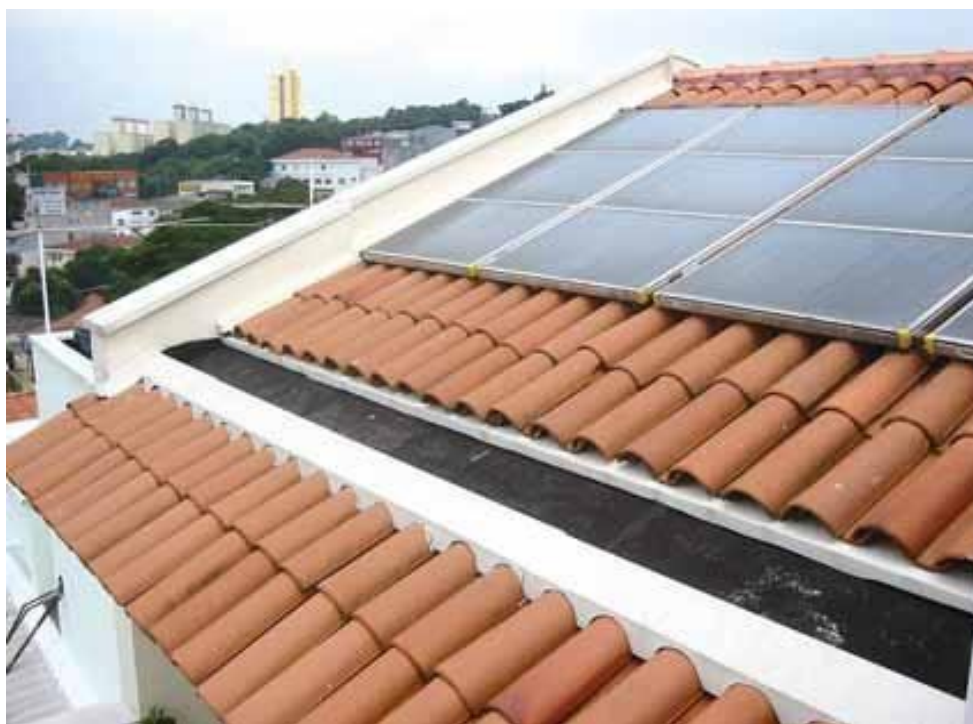
Fotografia 18 - Calha coletora em posição intermediária permitindo alimentação do reservatório superior de água pluvial por gravidade
